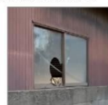
窓が割れた管理不全空家
