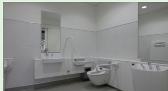
多目的トイレ (吉野川市庁舎)
