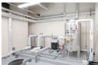
※2 雨水処理装置(雨水利用)
