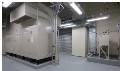
※5 非常用発電機
