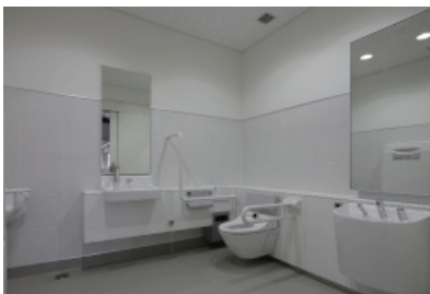
多目的トイレ（吉野川市庁舎）
