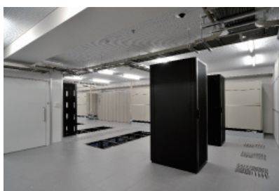
サーバー室 (茅ヶ崎市庁舎)
