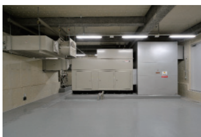
自家発電設備 (茅ヶ崎市庁舎)
