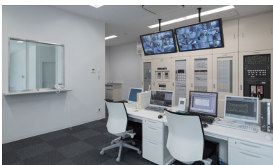
※4 照明・空調の集中操作設備
