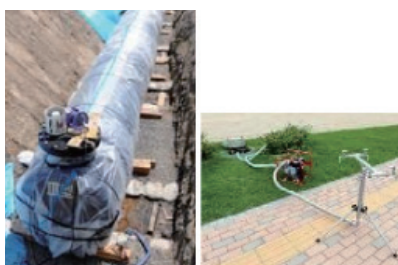
※5 耐震性貯水槽
