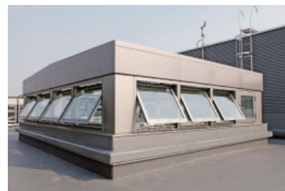
自然換気促進装置
