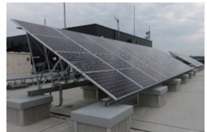
太陽光パネル（周南市庁舎）
