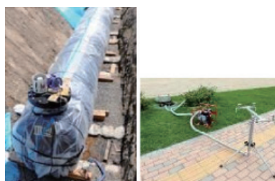
※5 耐震性貯水槽
