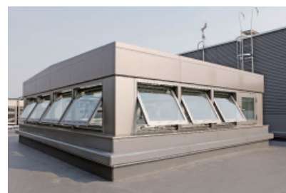
自然換気促進装置
