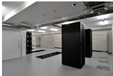
サーバー室（茅ヶ崎市庁舎）
