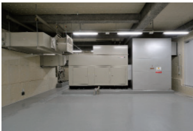
自家発電設備（茅ヶ崎市庁舎）
