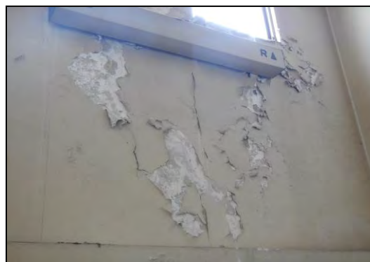
【内壁の剥離・ひび割れ】
