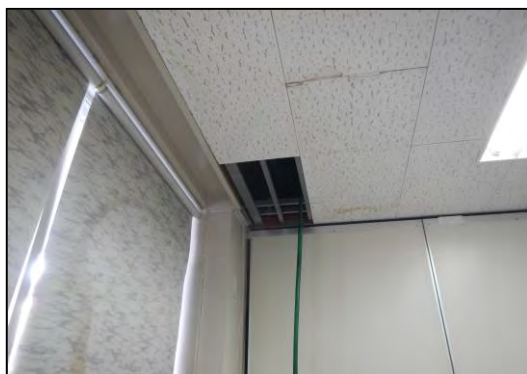
【天井の雨漏り】
