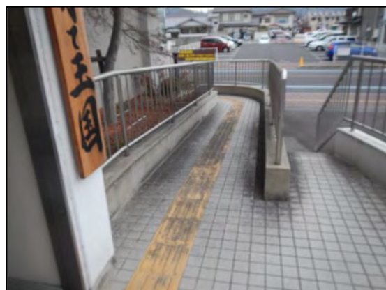
【勾配が急な西庁舎玄関スロープ】
