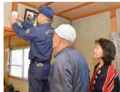
寝室に住宅用火災警報器を設置
