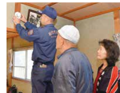
寝室に住宅用火災警報器を設置
