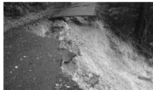
9月の豪雨で崩落した宇山地区内の市道
