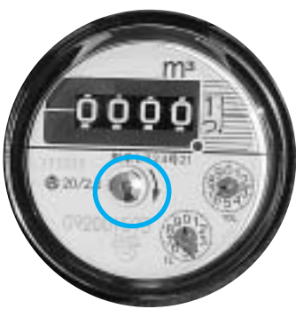
メーターボックス（写真上）は検針しやすいようにしてください。パイロットマーク（写真右の丸部分）が、水道の蛇口を全部閉めても回転している場合は、漏水の可能性がります
