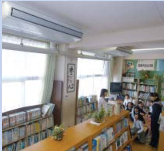
秦小学校の図書室の空調設備
