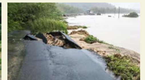
堤防が決壊し水没した草田地区
