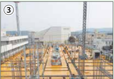
【3月14日】 庁舎棟では、2階の床部分の型枠と鉄筋工事を施工しています。
