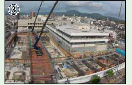
【9月12日】 構台が完成しました。庁舎棟・議会棟ともに基礎の配筋工事をしています。
