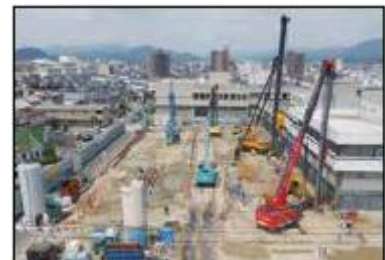
Ngày 13/6 Bổ sung thêm 2 máy thi công hạng nặng khu vực phía tây, cải tạo nền để chuẩn bị cho công tác thi công
