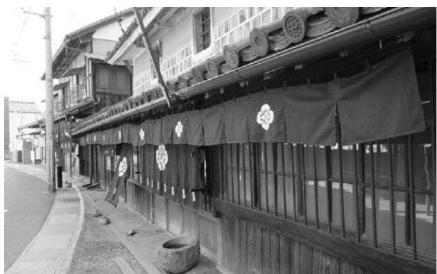
老朽化が心配される堀家住宅(総社二丁目)
