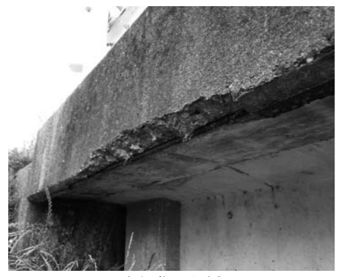
老朽化した橋
