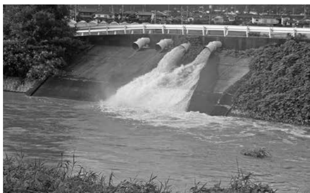
豪雨時に富原排水機場から吐出される様子(新本川)
