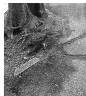
木の根により隆起した歩道
