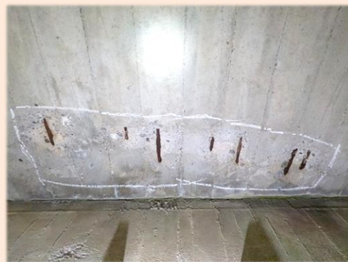
床版の鉄筋露出 (3039道1号橋 下倉支線3039号道)
