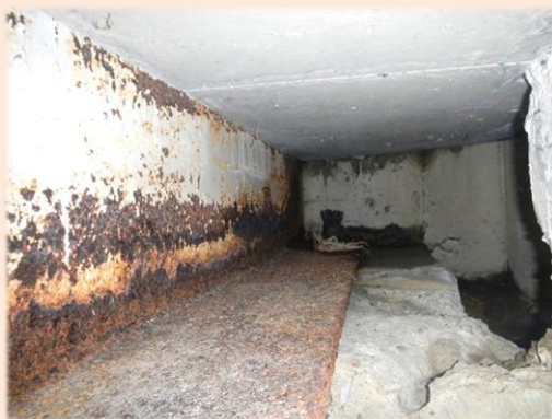
鋼材の腐食 (土井橋 原支線3048号道)
