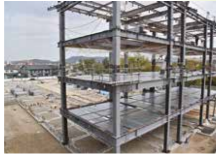
改築工事が進む総社小学校。来年1月の完成を予定している
