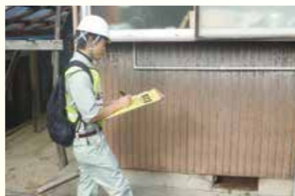
被災建築物を確認して回る
