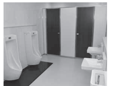
改修されて使いやすくなった、市役所1階市民課前の多目的トイレ(写真上)と2階議場前の男子トイレ(写真下)
