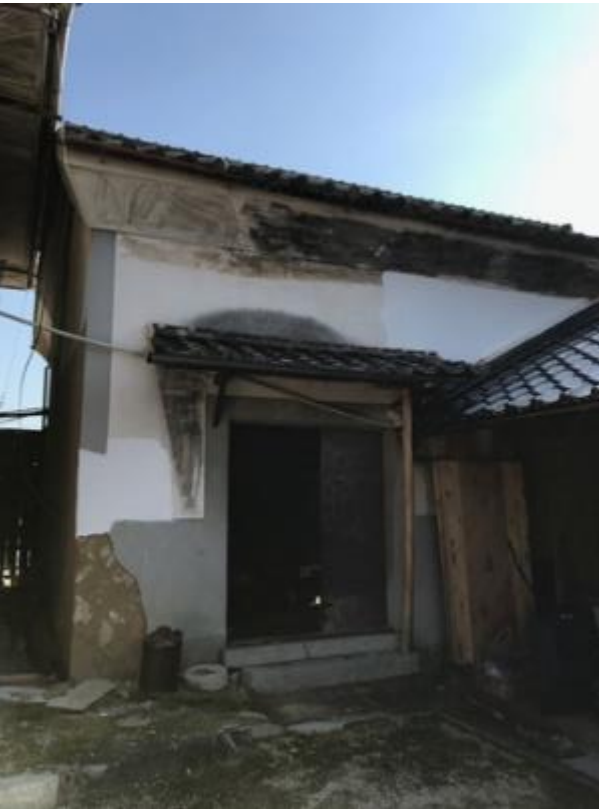
痛んだ外壁・入口部分
