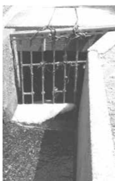
農業用水路に設置されたスクリーン
