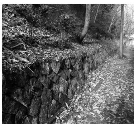
対策が必要な秦小学校裏山の危険箇所
