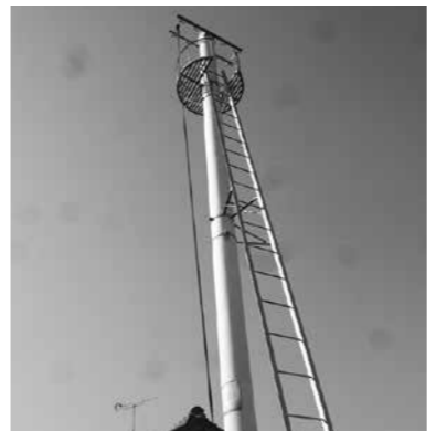
落下の危険があり鐘が外されている半鐘塔
