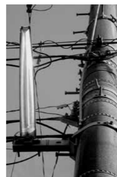
自由交付金を活用して設置されたLED街灯(泉地区)
