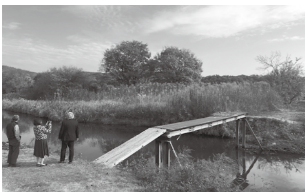
足守川に架かる壊れたままの橋を確認
