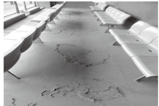
床が劣化している野球場のダッグアウト
