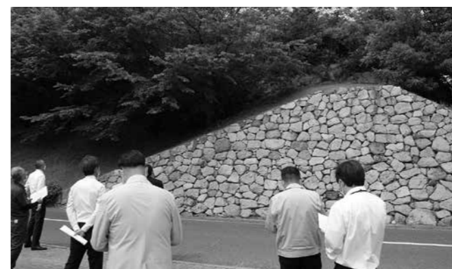
岩の崩落箇所の確認
